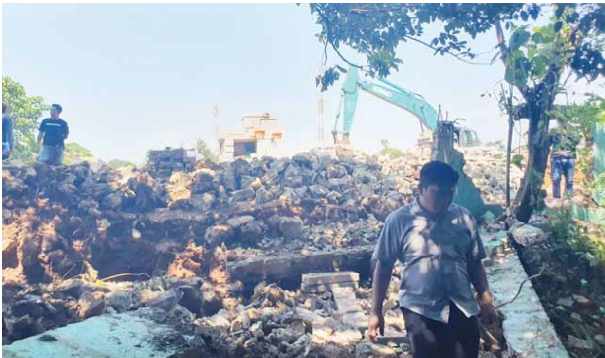
DINDING ROBOH: Proyek pembangunan perumahan yang diduga menjadi biang kerok ambruknya tembok di SDN 01 Cipayung, Kelurahan Tengah, Kecamatan Cibinong, Senin (5/5).
